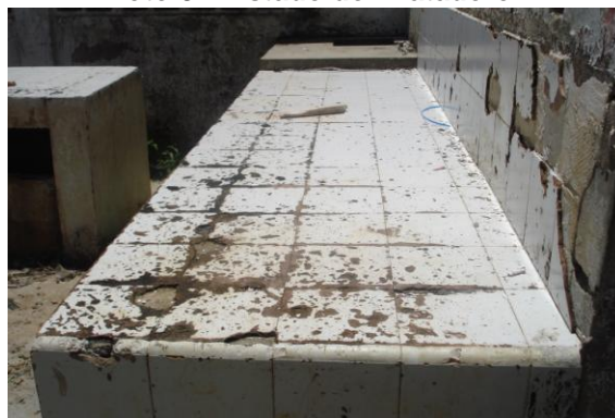
Foto 32. Estado del matadero.
