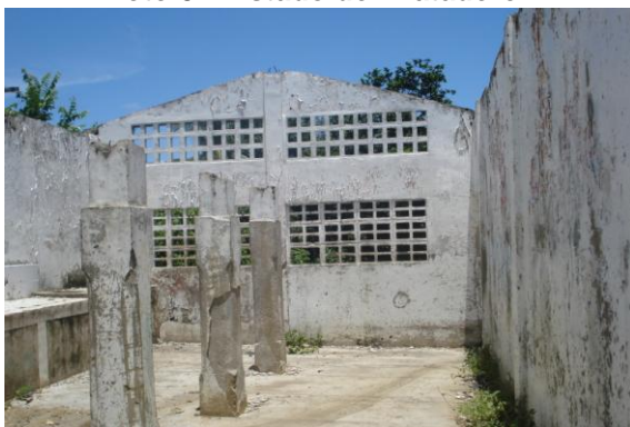
Foto 31. Estado del matadero.
