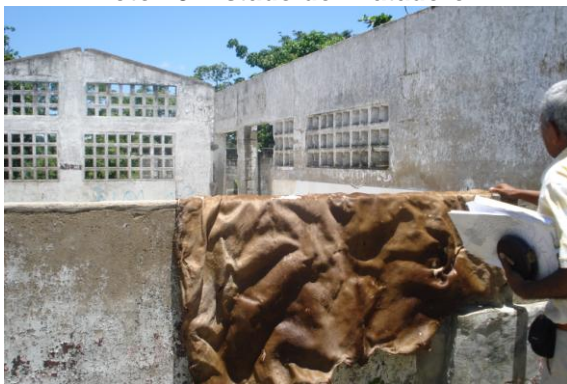
Foto 29. Estado del matadero.
