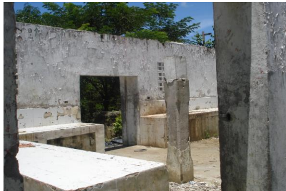
Foto 30. Estado del matadero.
